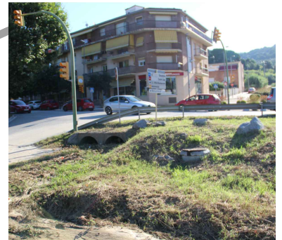
Conductes pluvials en desús i pou d'aigües residuals 1
