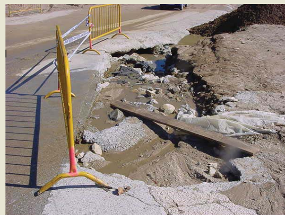
Desperfectes a la carretera
