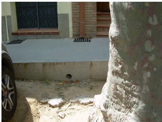
Reixes interceptores a peu de baixants de cobertes, amb connexió a escocells.
