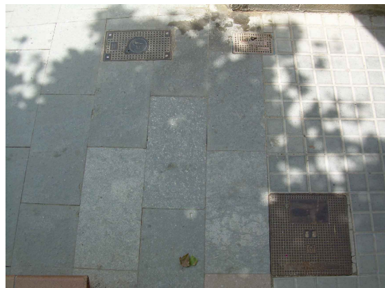
Cantonada nord Riera amb c/. de la Rasa. Vàlvules xarxa aigües i boca de reg.
