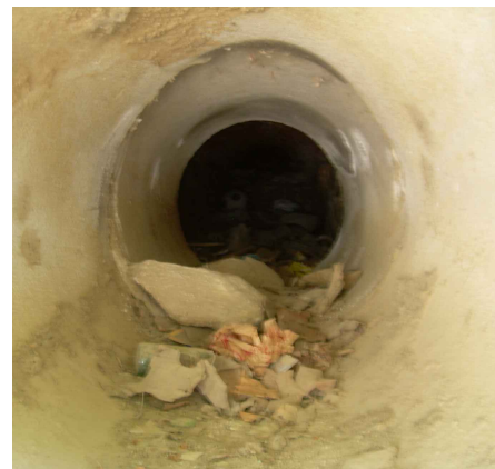
Detall conducte, pendent de manteniment.
